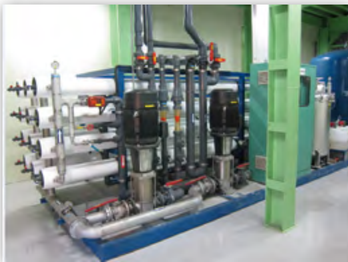
● RO給水系統
