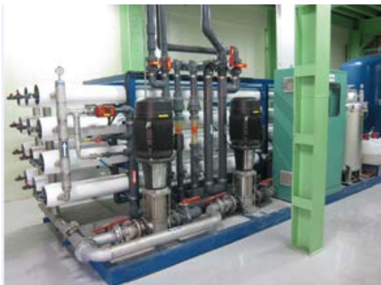
● RO給水系統
