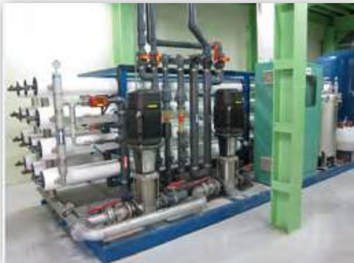
● RO給水系統
